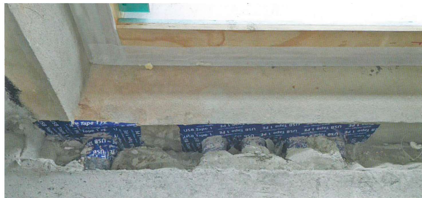
3/3 LATO INTERNO. Sigillatura dei cavi: sia sul lato interno che sul lato esterno, i passaggi impiantistici devono essere sigillati o con nastri acrilici adesivi o con barriere all'aria liquide, date a penello, che garantiscano la tenuta all'aria.
